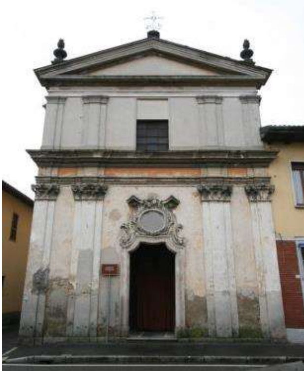
La facciata prima del restauro Evidente stato di degrado
