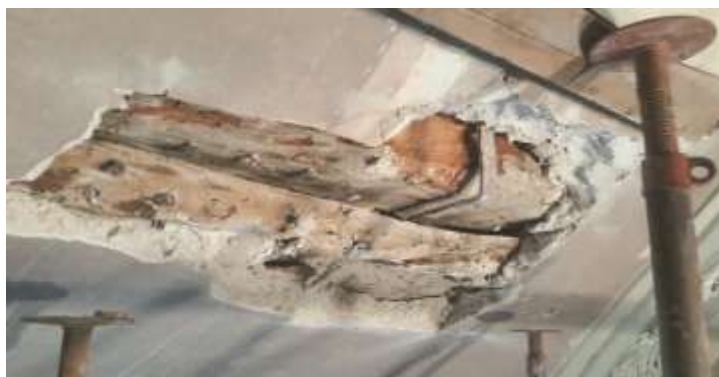
Particolare dei danni interni provocati dall'abbassamento del trave catena
