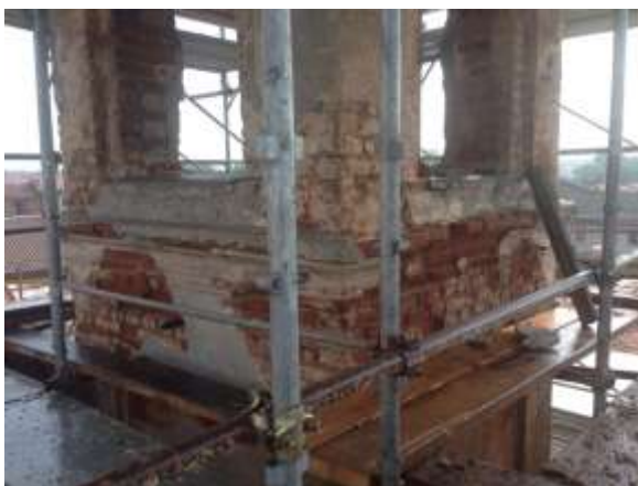
Campanile prima dell'intervento con gravi danni agli elementi decorativi in rilievo
