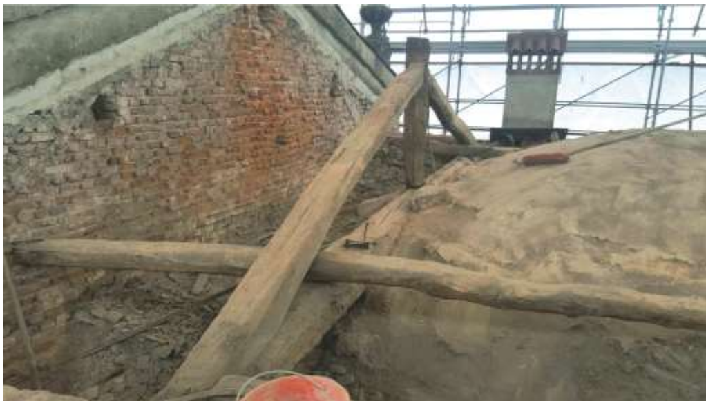
Visione del punto di intersezione tra trave-catena con la volta che ha causato la caduta degli intonaci interni della chiesa
